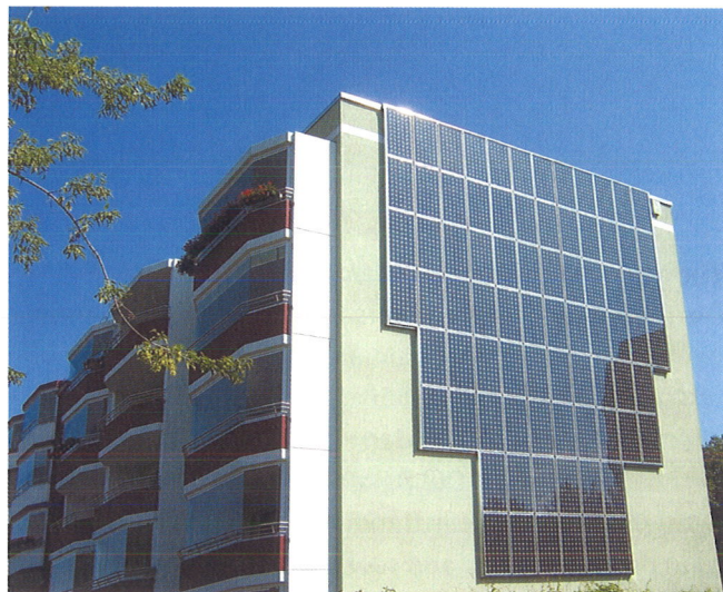
Fotovoltaikanlage in der Georg-Benjamin-Straße
