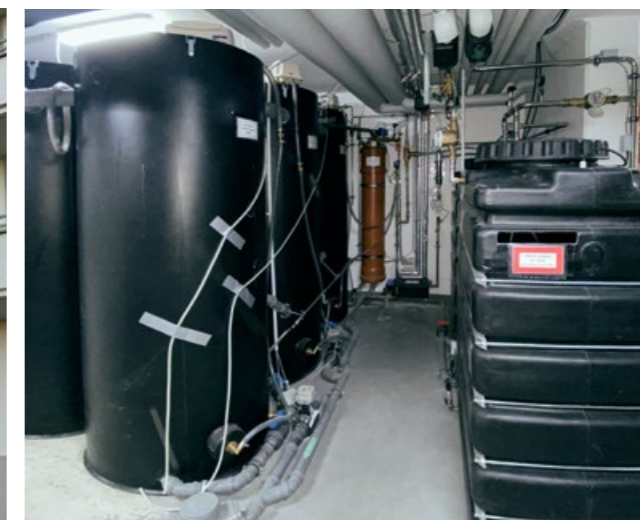
Grauwasserrecyclinganlage am Beispiel Dolomitenstraße 47/49
