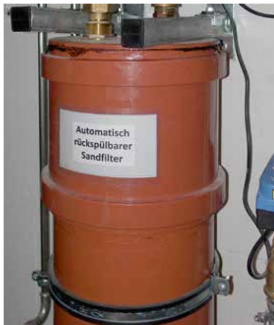
Der Sandfilter, von oben nach unten durchströmt, befreit das biologisch aufbereitete Wasser effektiv von feinsten Schwebstoffen. Das ist eine Voraussetzung für die optimale Wirkung der anschließenden UV-Desinfektion.
