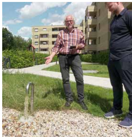
Der unterirdische Regenspeicher liegt im begrünten Innenhof und fasst 100 m 3 . Ist er voll, wird ein Teil automatisch, zur Versickerung in einer Mulde, an die Oberfläche gepumpt. Das schafft wieder Raum für Regenrückhaltung.
