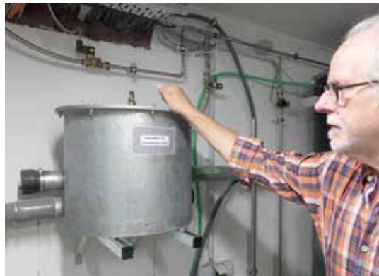
Planer Erwin Nolde im Technikraum. Das Sieb im Zulauf filtert Haare und Partikel, bevor das Grauwasser in den Wärmetauscher und die rein biologisch arbeitende Behandlungsanlage gelangt. Das Sieb wird periodisch rückgespült.
